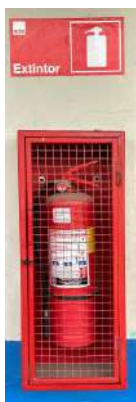
Extintor de PQS
