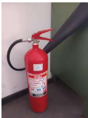
Extintor CO2 9 kilos
