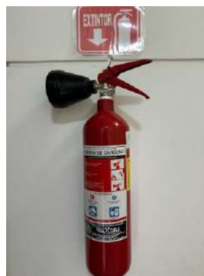
Extintor CO2 2 kilos
